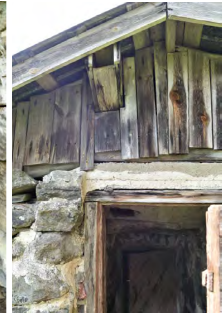
Kuva: Eteistilan laudoista tehty poistoilmahormi.
