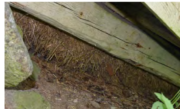
Kuva: Vesikaton vanhaa veistohirsistä tehtyä rakennetta. Katon eristeenä on maata ja olkia.
